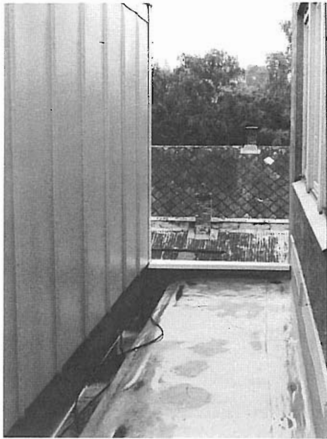
Fig. 6.6 Her er ikke kablene festet, og resultatet er at kablene ikke ligger der de skal være.
