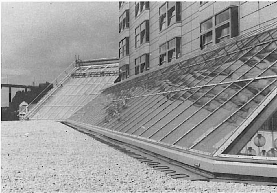
Fig. 9.13 Liten vegg høyde ved takfot. Varmekabler smelter snøen
