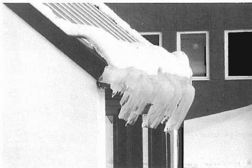
Fig. 9.4 Smeltevann vil fryse på uoppvarmet renne
